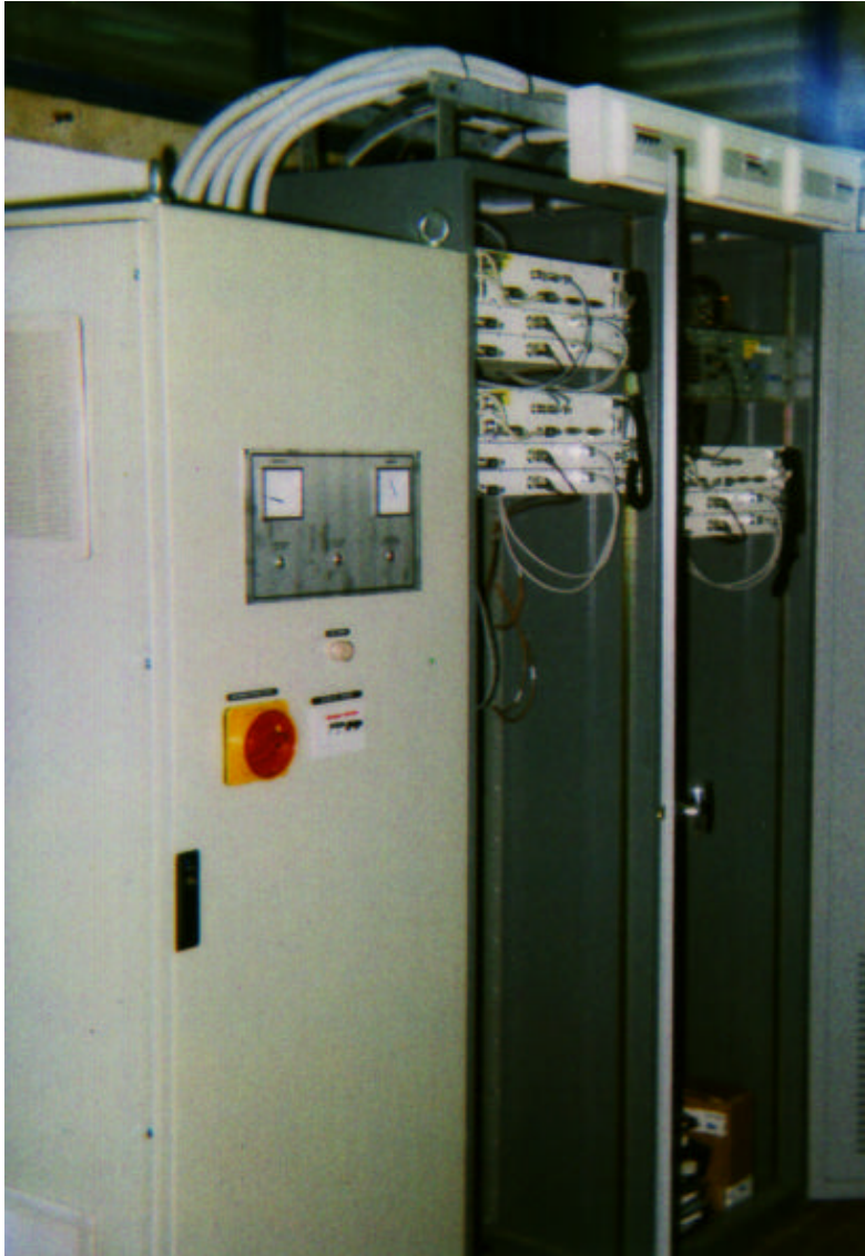
Alimentatore generale e apparati radio per le tratte verso Cesena e Forlì.
