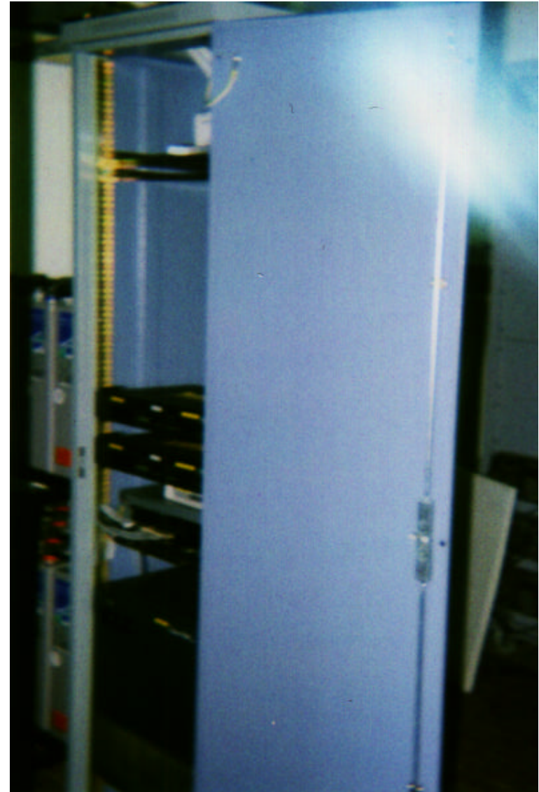
Gli apparati di routing.
